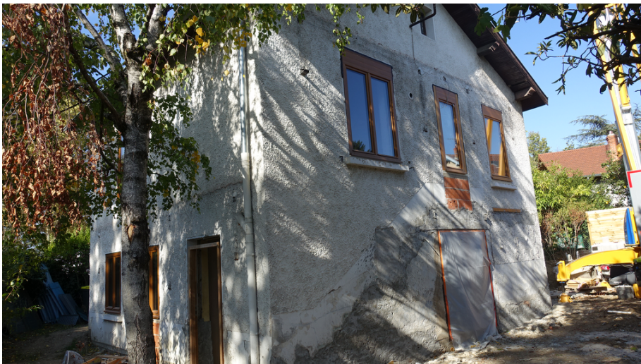
3. Façade sud-est après dépose de l'escalier, du balcon, de la véranda et de la marquise
