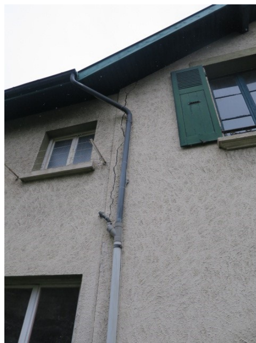
4. Fissure entre l'extension et l'ancien. Source : Soraetec
