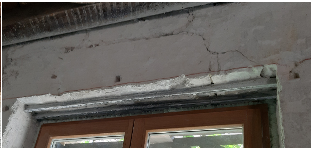
5. Linteau fissuré renforcé
